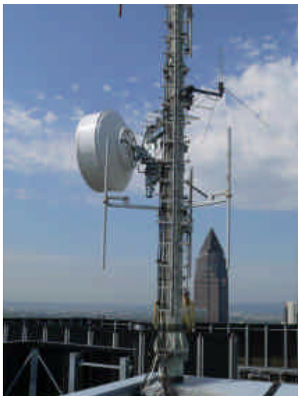
Installierte 60 cm Antenne am Umlenkstandort
